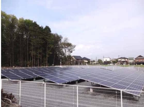
刑部第1太陽光発電所（宇都宮市）
