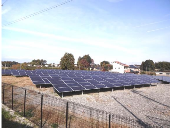
壬生太陽光発電所（下都賀郡壬生町）
